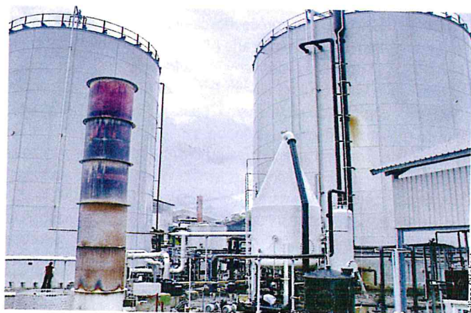
Le projet Enervidil a conduit à la méthanisation des vinasses de rhumerie de la distillerie Rivière du Mât, permettant l'autonomie énergétique de son process industriel.
