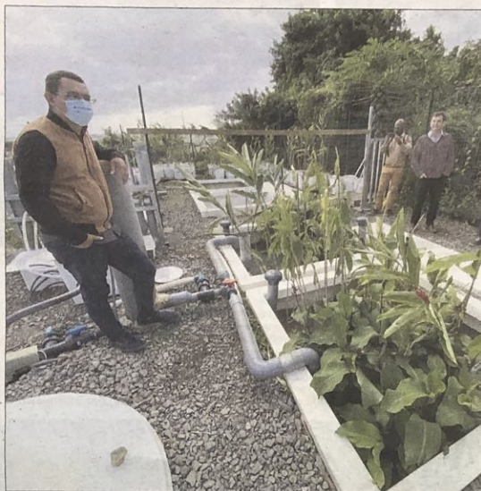
Bourbon Composites a déployé deux installations pilotes à Saint-Benoît et à Saint-Paul. (Photos E.M.)
