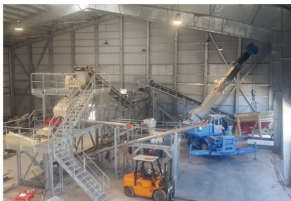
CVD - Ligne de traitement du plâtre
